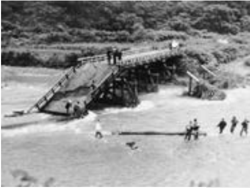
昭和36年災害 〈ヤエダウス橋〉
