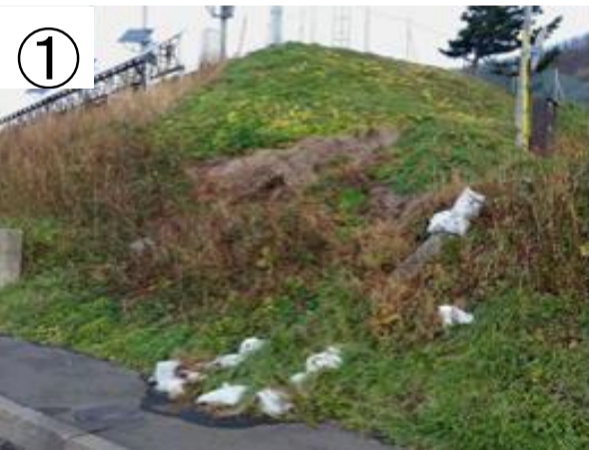
1 グランド脇の排水溝 雨が急激に降ると、水が噴き出す!
